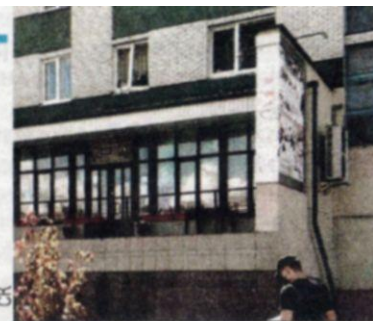
С улицы видны повреждения окон в пинской квартире.
